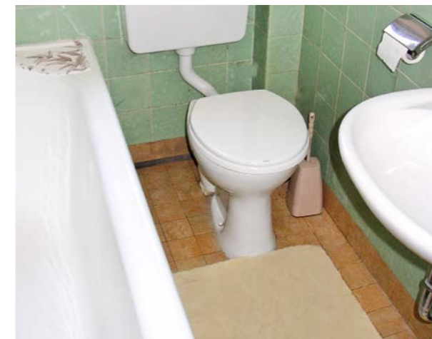
Vorher: Das enge Bad ließ sich nicht mehr benutzen.
