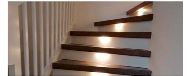
Die Stufenbeleuchtung wird über Bewegungsmelder gesteuert.
